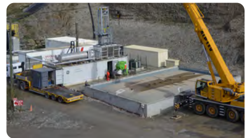
Behandlungsbecken für verschiedenste Abwässer
